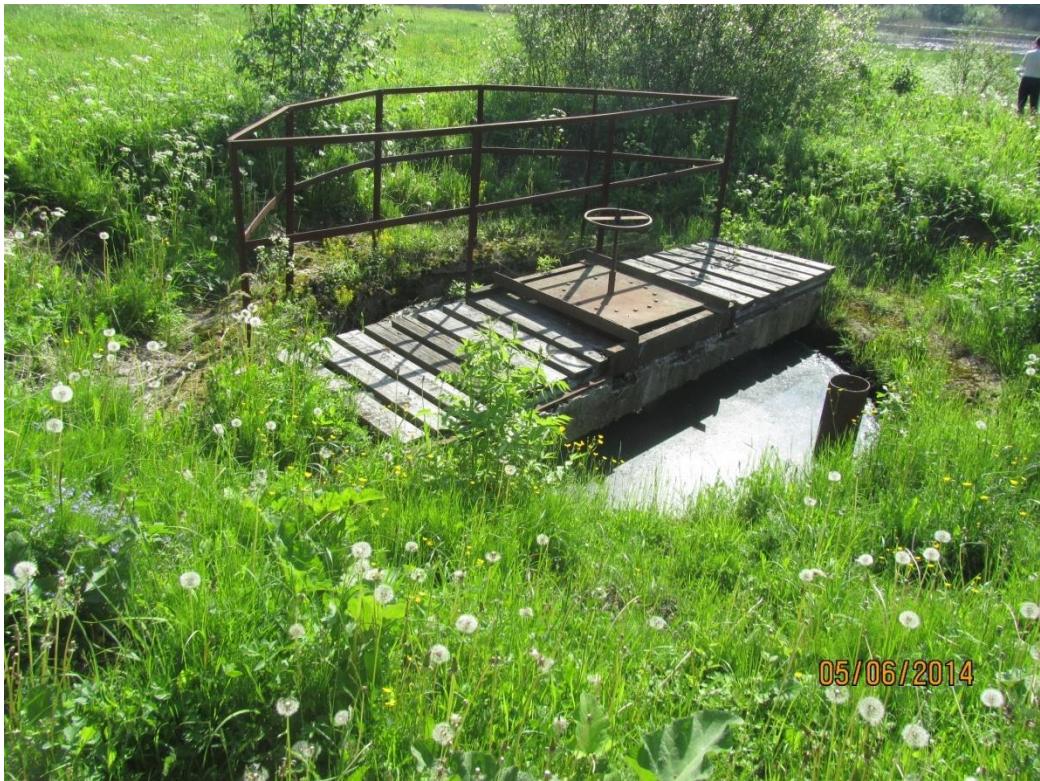
Рис. 5. Сооружения для очистки сточных вод.
