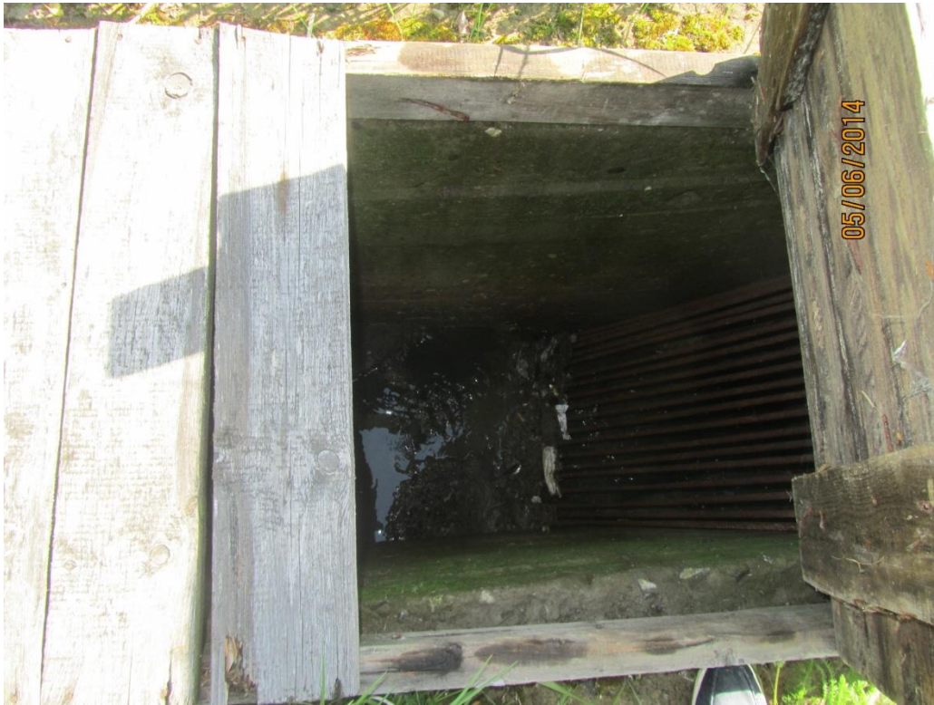
Рис. 8. Сооружения для очистки сточных вод.
